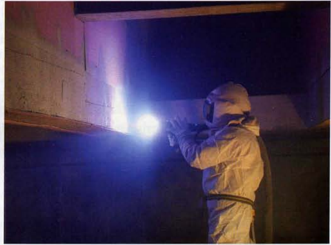
Bild 2. Bei der Spritzverzinkung wird der Beton großflächig mit einer aufgespritzten Zinkschicht versehen (Fotos: INITIATIVE ZINK)
