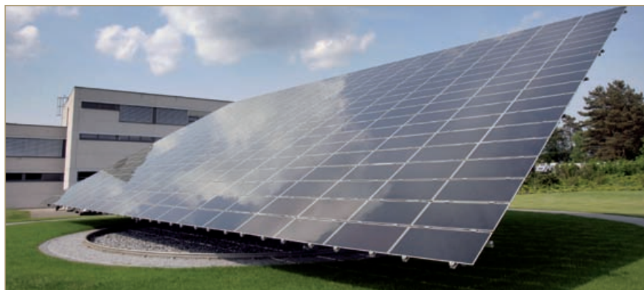
Das feuerverzinkte SunCarrier-System wird nicht nur in Südeuropa, sondern auch in Deutschland erfolgreich eingesetzt. (Quelle: Institut Feuerverzinken)
