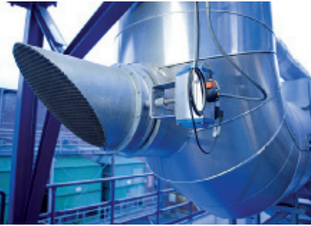
Filter in der Wärmerückgewinnungsanlage
