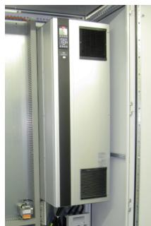
Frequenzumrichter verbessern das Drehzahlverhalten von Elektromotoren
